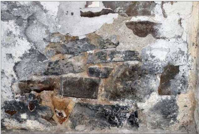
Feuchte- und salzbelastetes Bruchsteinmauerwerk 2015
