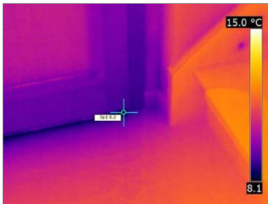
Eingangstür mit niedriger Temperatur des Rahmens und der Umgebung (Innenaufnahme)
