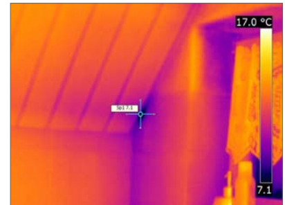
Undichtigkeit im Übergang von Giebelwand zum Dach (Innenaufnahme)
